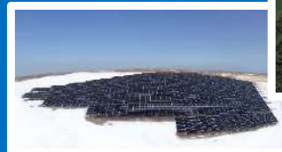
苫小牧太陽光発電所
