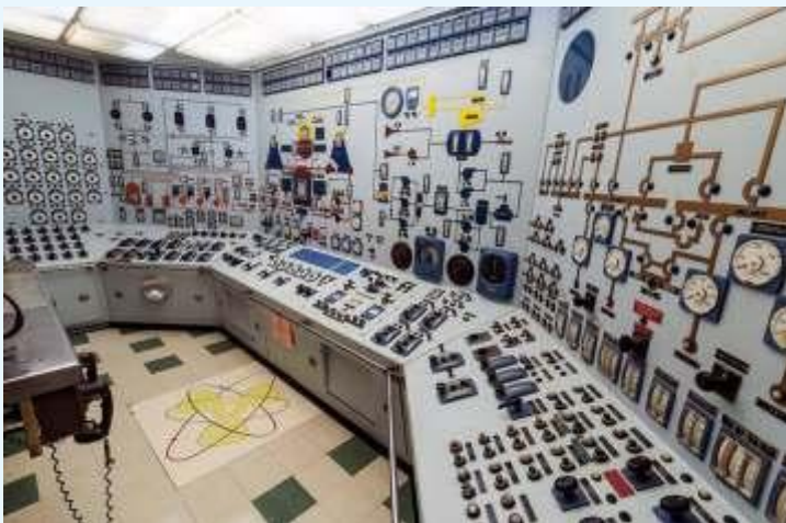
Maschinen-Kontrollraum der Savannah
