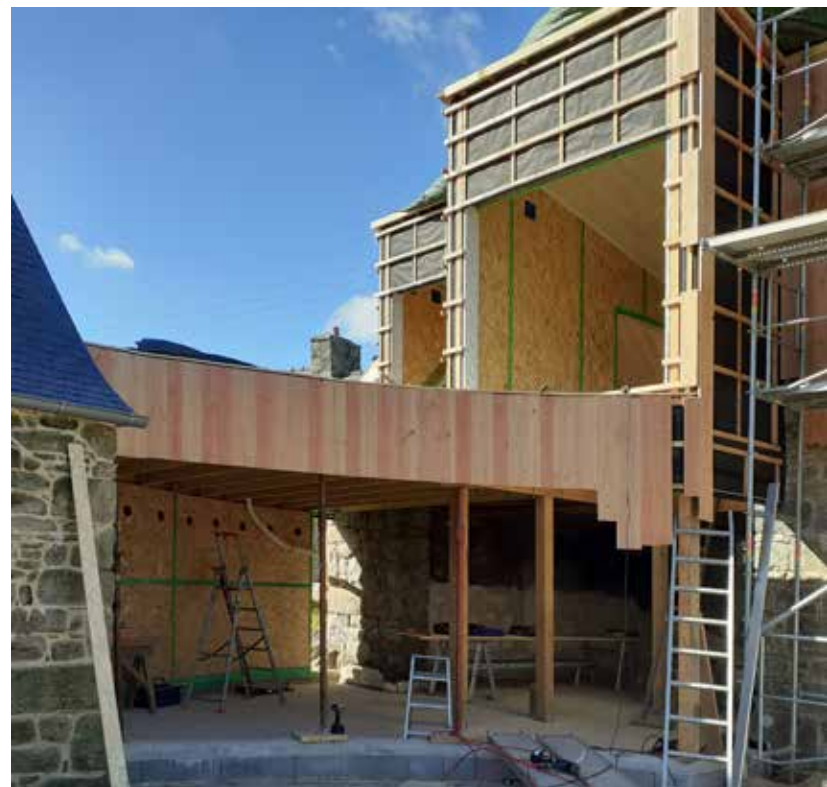
L'ossature bois vient se greffer sur la pierre ouvrant de nouveaux espaces habitables.
