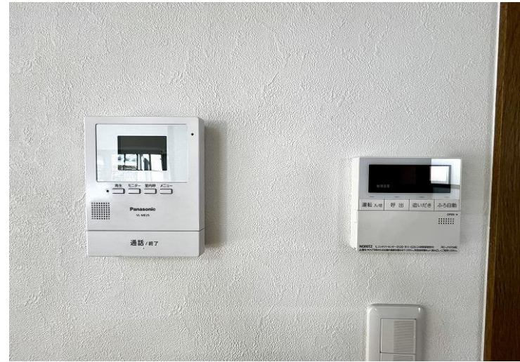
インターホン・給湯リモコン
