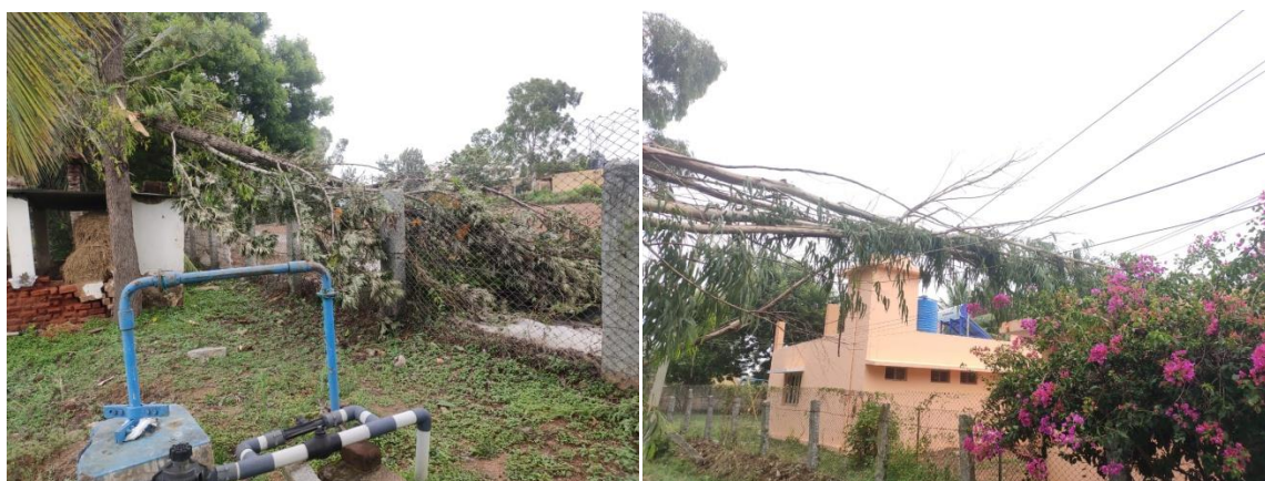
Niedawne szkody spowodowane burzą, w tym szkody w instalacji elektrycznej
