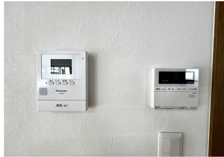
インターホン・給湯リモコン
