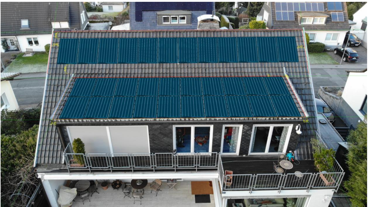
PV Anlage Süd
