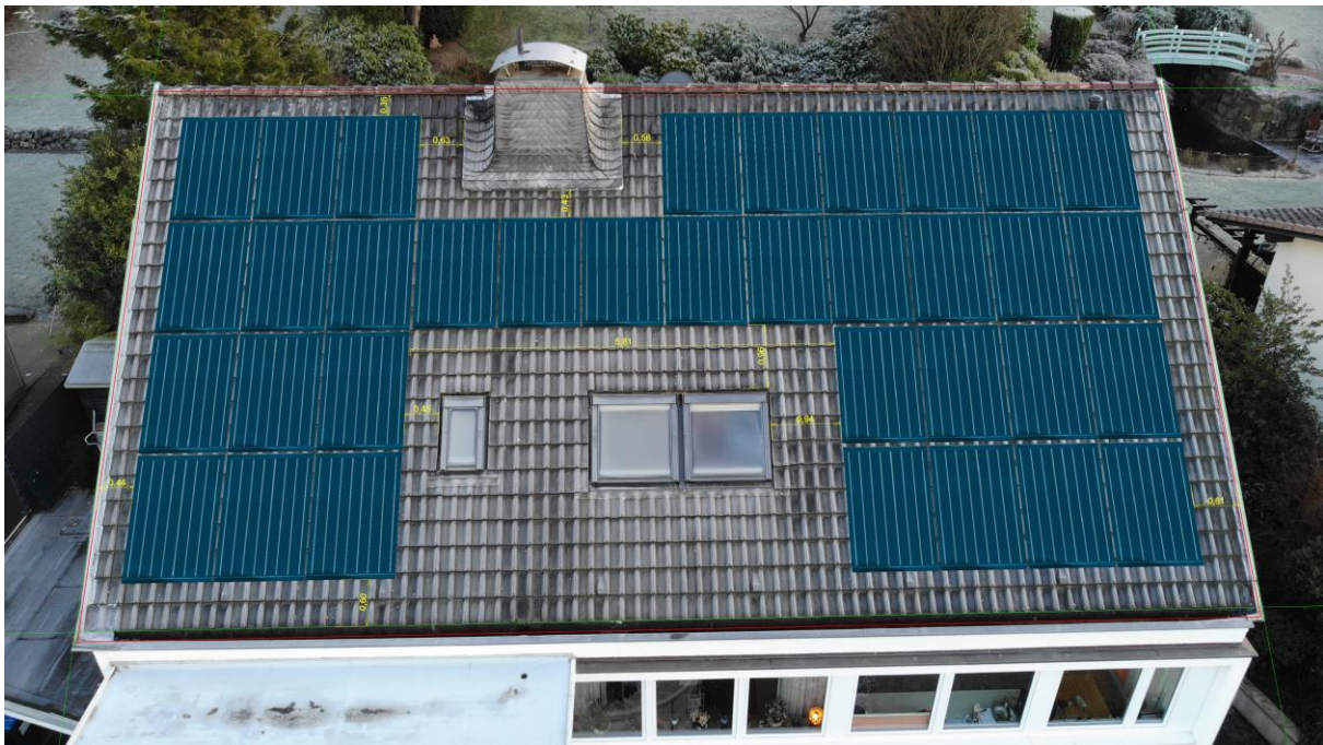
PV Anlage Nord
