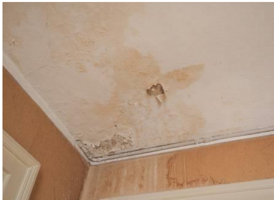
Abbildung 4 Decke der unteren Wohnung ( https://de.123rf.com/lizenzfreie-bilder/wasserschaden )
