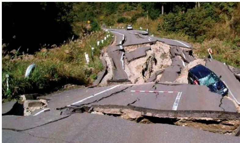
中越地震における道路損傷（R252） 10
