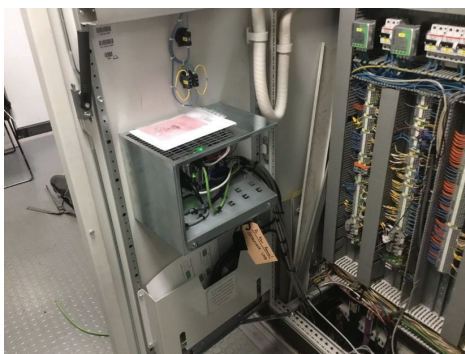
System Unit im Maschinenkontrollraum
