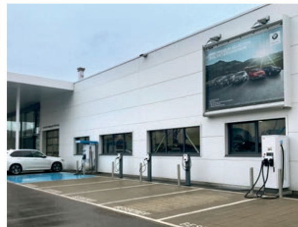
Unsere neuen Ladestationen in Schaffhausen
