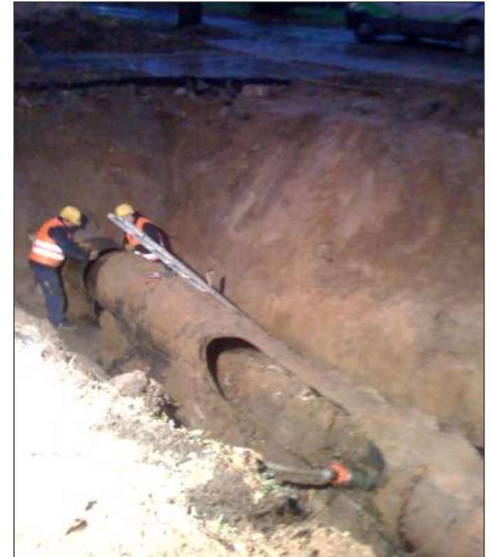
12.11.2010 Te-Damm/Paradestr. - Schalenbruch ADL DN 750 und Kraterbildung auf der Fahrbahn
