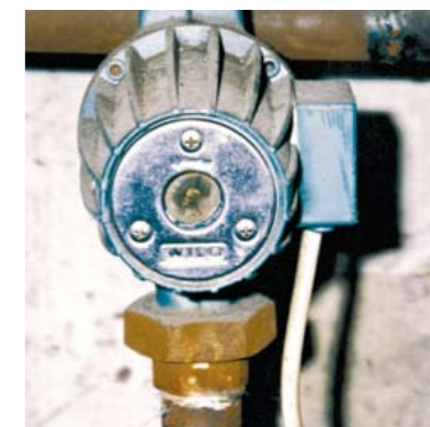
▼ Alte, unregulierte Pumpe
