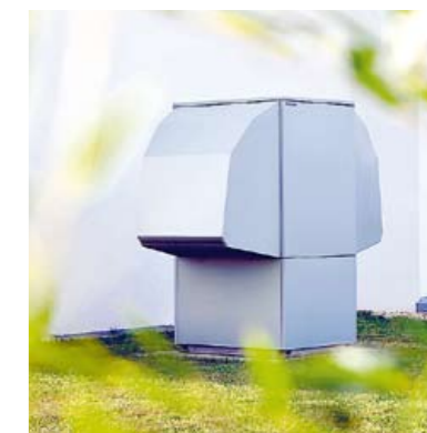
▲ Geschickte Integration einer Luft/Wasser-Wärmepumpe in die Außenanlage
