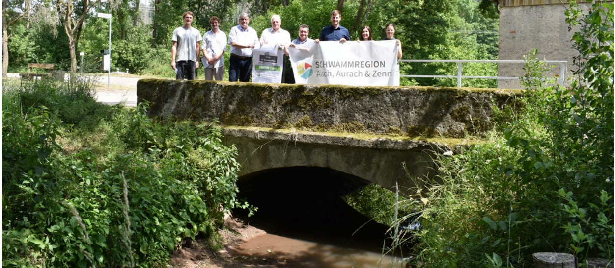
Zum Thema Schwammregion fand ein Pressetermin in Steinbach statt. Die Brücke, auf der die Teilnehmer stehen, wurde beim Starkregen enorm beschädigt, Gebäude standen meterhoch unter Wasser. Foto: Ute Niephaus
