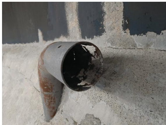
Korrodierte Rohrleitung im Faulturm
