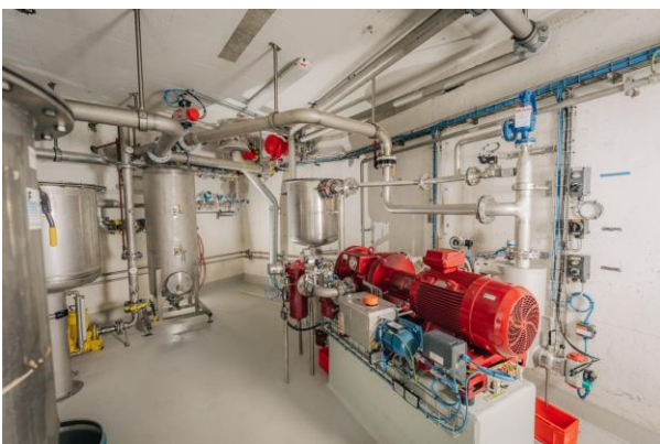
Sanierte Gasanlagen inkl. neuem Gaskompressor
