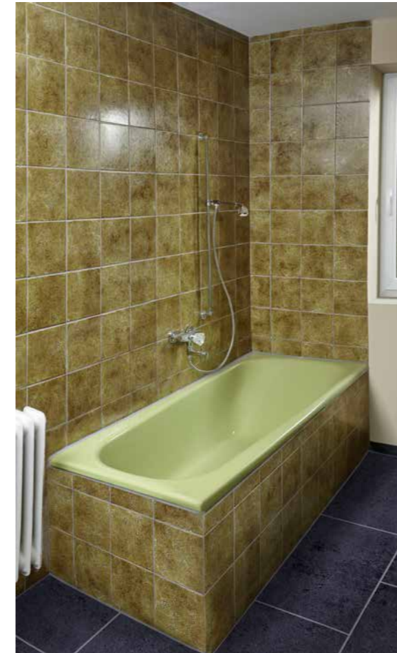
Ein gängiges Bad mit zu hohem Wannrand, kaputten Fugen und alten Armaturen.
