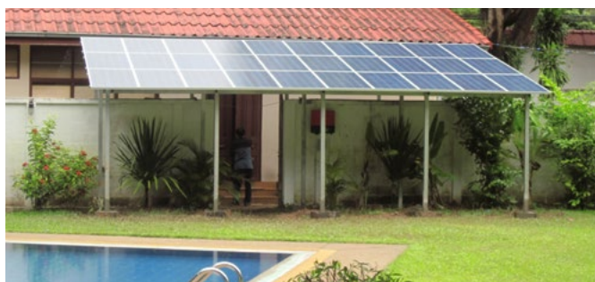
Stromversorgung bei Netzausfall
