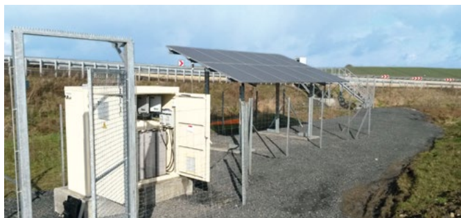
Stromversorgung einer Mess-Station zur Geschwindigkeitskontrolle
