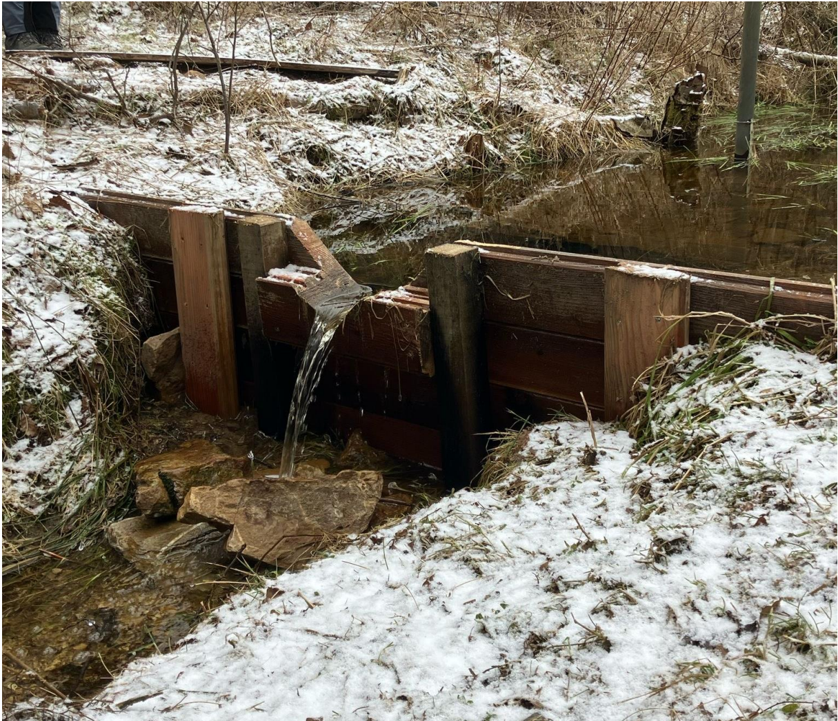
Abb. 1: Durch Spundwand mit Überlauf verschlossener Entwässerungsgraben im Soonwald. Foto: Sabeth Häublein
