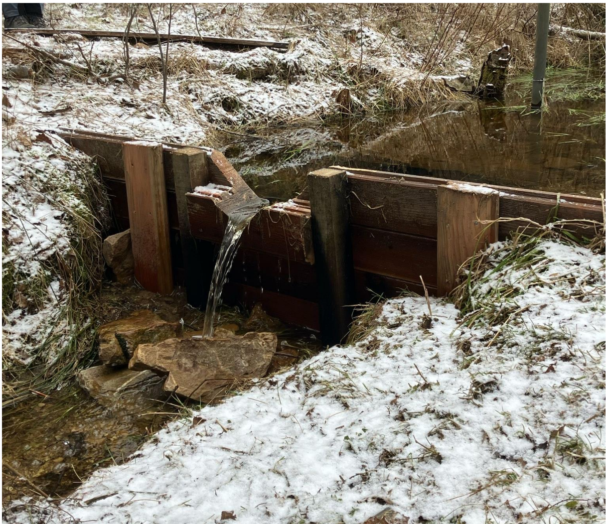
Abb. 2: Durch Spundwand mit Überlauf verschlossener Entwässerungsgraben im Soonwald. Foto: Sabeth Häublein
