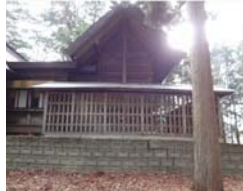
本殿の盛土の基礎にクラック ⇒基礎改修と本殿修繕
