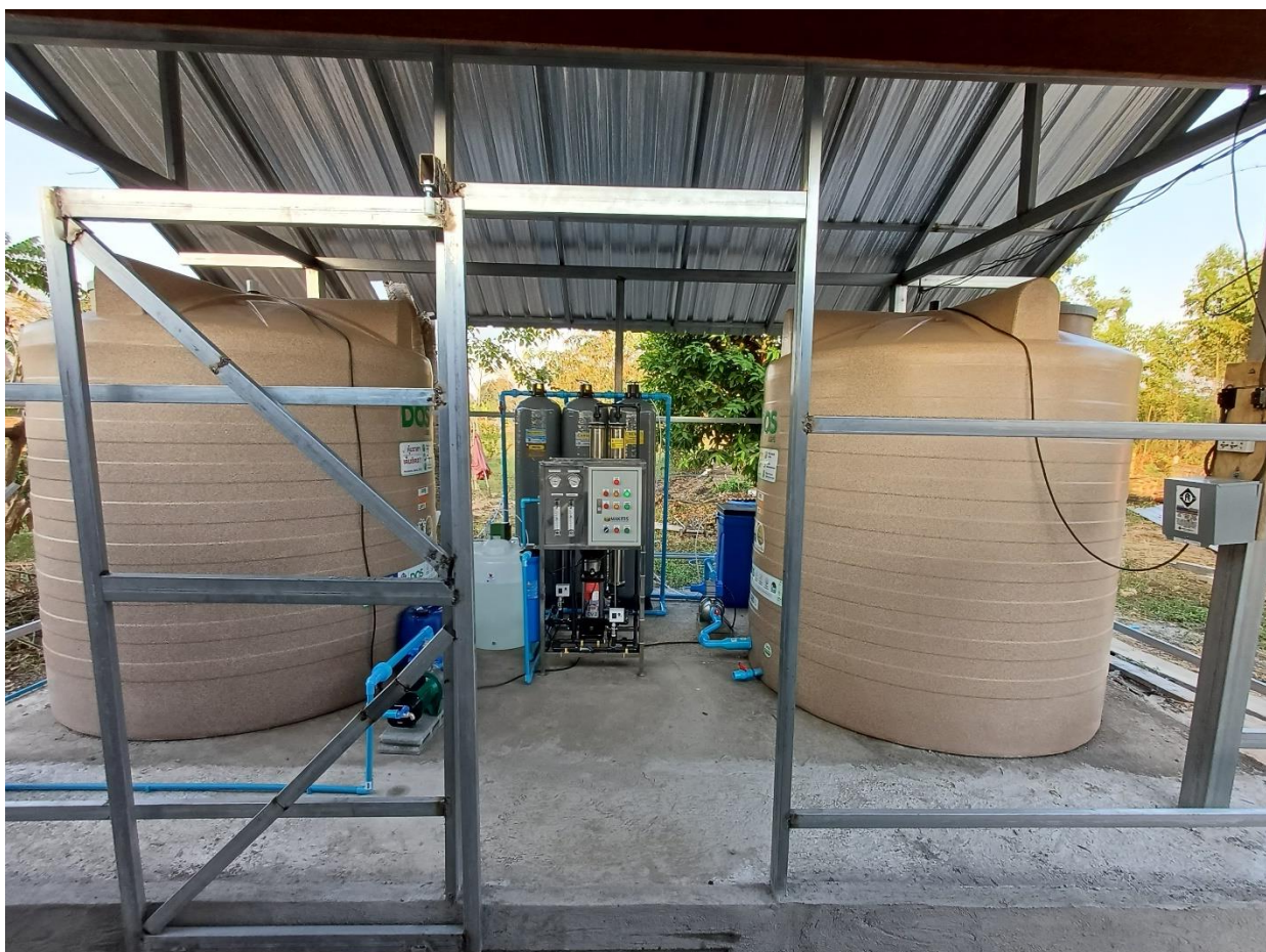
Voorfiltratie en RO-systeem, tanks zijn Food Grade gecertificeerd / Pre-filtration and RO-system, tanks are Food Grade certified / Vorfiltrierung und Umkehrosmosesystem (RO). Behälter sind Food Grade zertifiziert
