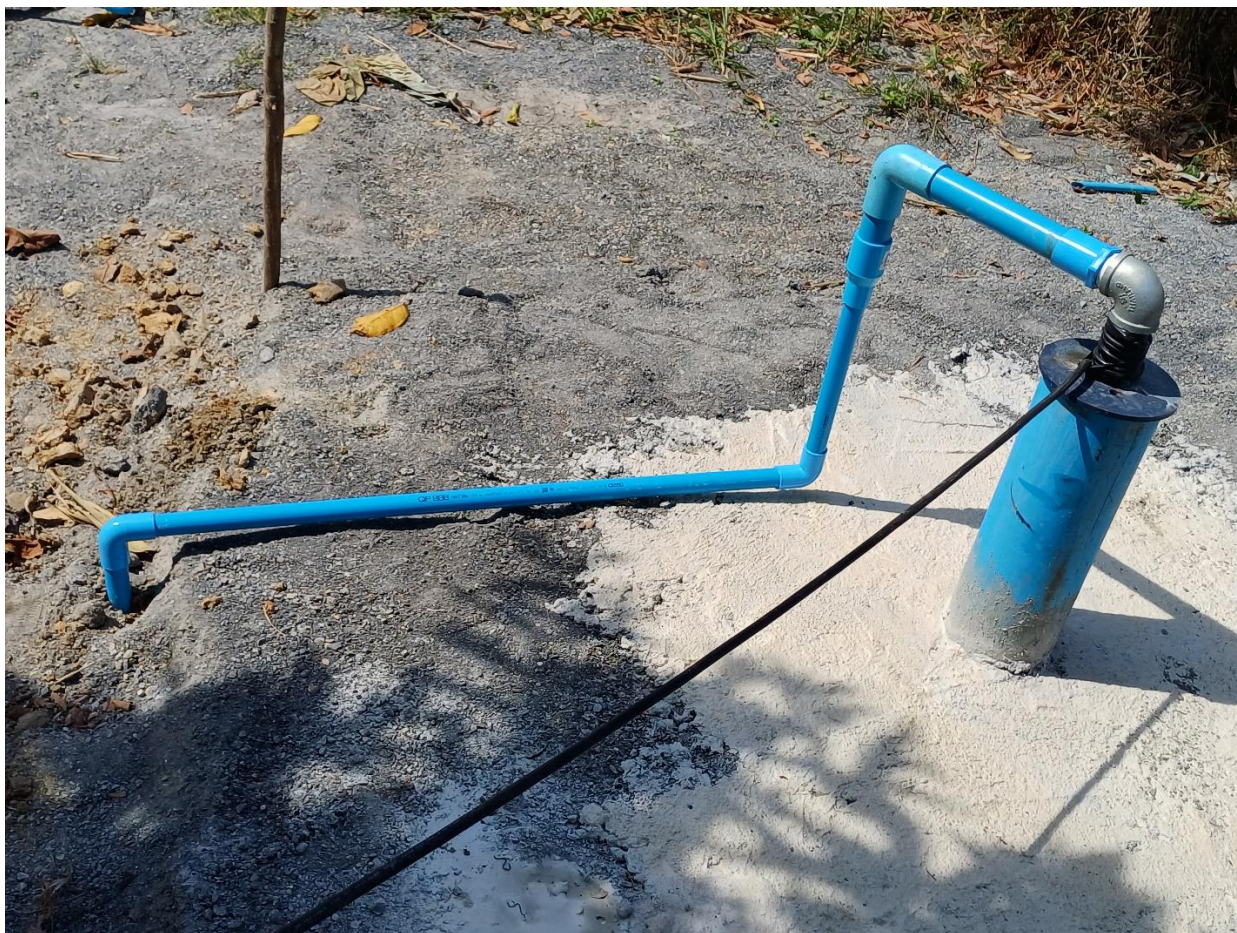
Bronwaterput, 130 mtr diep / deepwell, 130 mtr deep / Grundwasserquelle. 130 Mtr tief
