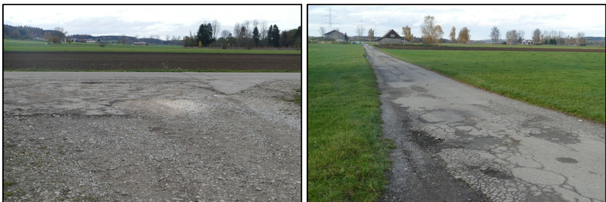
Abbildung 15: Schäden in der Asphaltdecke
