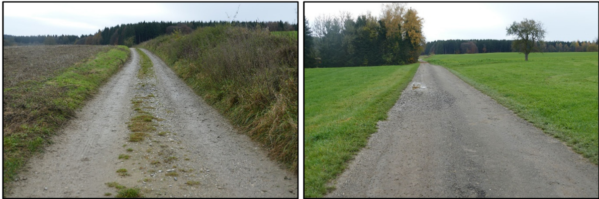
Abbildung 14: Schäden an Bankett und Seitenstreifen
