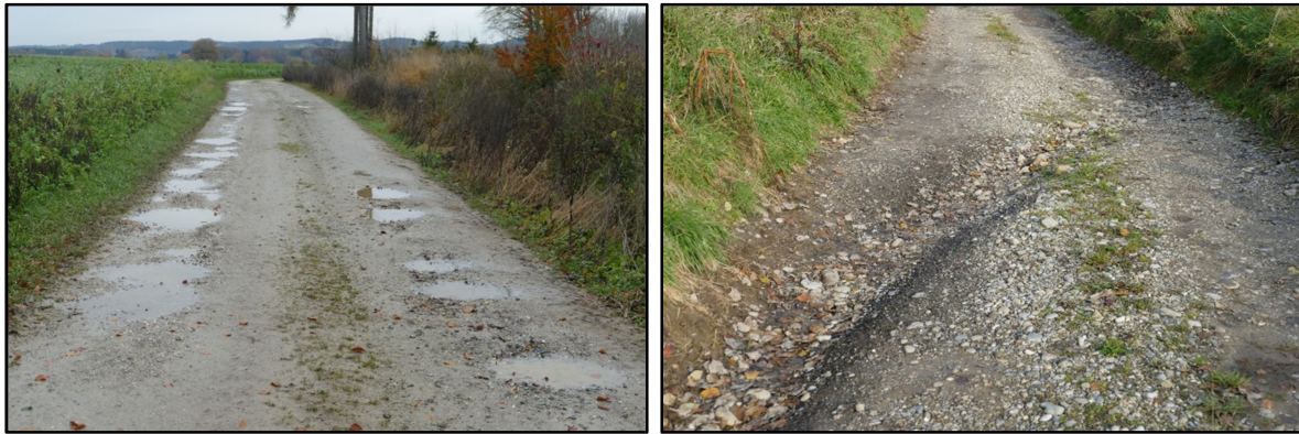
Abbildung 16: Schäden bei Schotterwegen
