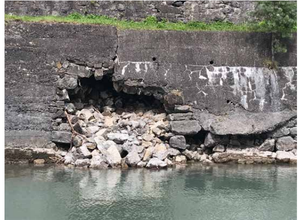
Unterspülung Stützmauer Seemülistrasse
