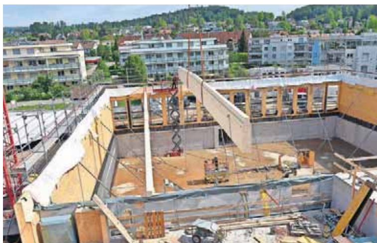
Blick auf den Rohbau der Turnhalle. Sechs solcher Holzträger bilden das Gerüst des Daches.
