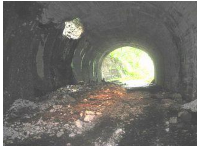
写真-4④ 二ツ小屋隧道米沢側坑口崩落状況
