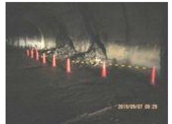
写真-11⑥ 二ツ小屋隧道内 崩落箇所へバリケード設置
