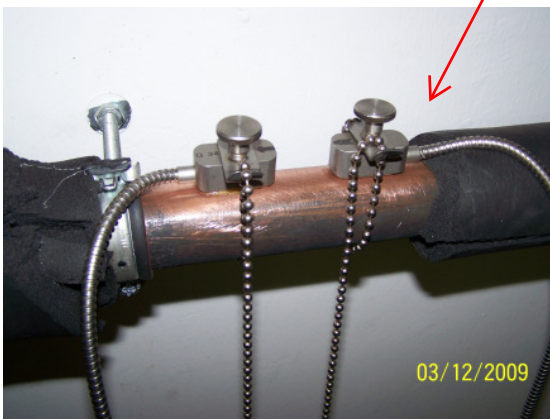
Z:\Projekte\2009-Projekte\2009-09 Le Meridien-Hotel an der Alster\Fotoanlagen Dokumentationen\Anlage 4 Durchflußmessungen\100_7352.JPG
